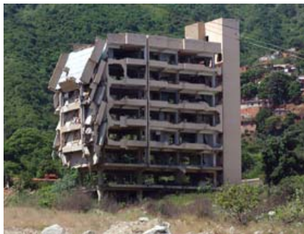
Edificio colapsado en Vargas.FOTO: Alberto Borrego (2)
