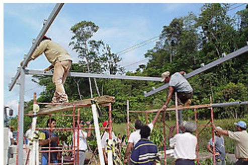
Construcción de viviendas con acero construidas por las comunidades en la Suiza, Municipio Sucre, 2006. FOTO: Prensa Mibam (3)
