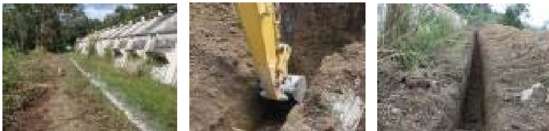
Figura 1.4.- Procesos para la realización de la zanja y compra de materiales. Fuente: Elaboración propia
