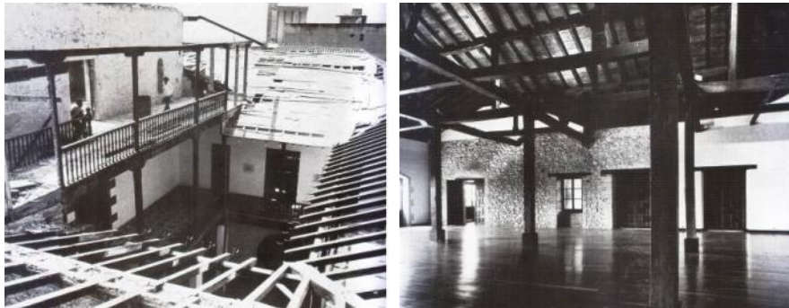
Imagen 8: Las obras de restauración de la Casa Guipuzcoana en los años 1975 y 1976 (Gasparini y Pérez Vila, 1981, pp. 372 y 377).
