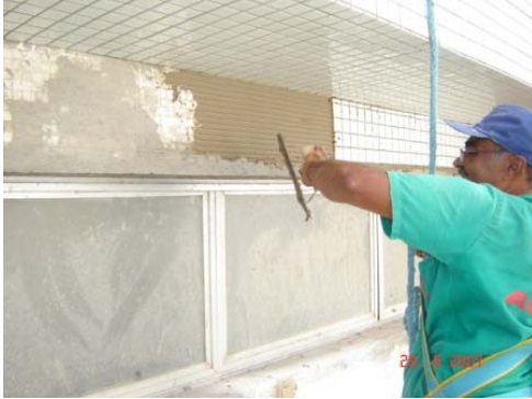
Figura 2 - Aplicação da argamassa colante com a desempenadeira de aço, utilizada na edificação B.
