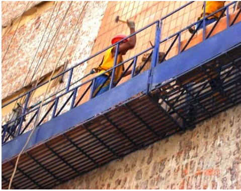
Figura 4 - Retirada do revestimento apenas com a marreta, aumentando o risco de acidentes na edificação E.
