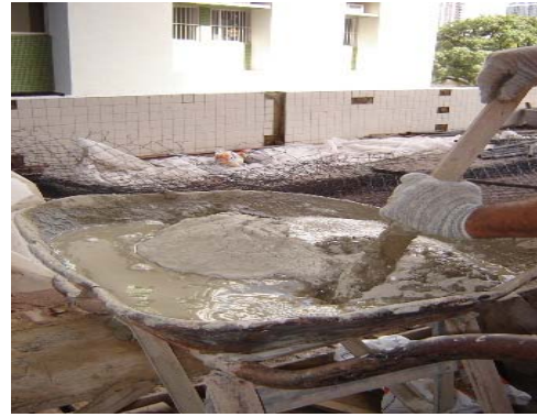
Figura 5 - Mistura manual da argamassa colante, diminuindo a produtividade do serviço executado na edificação E.
