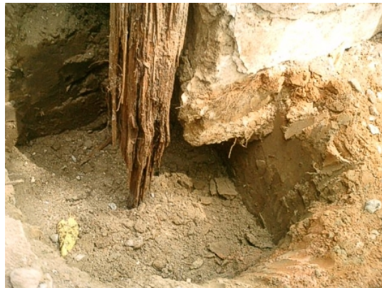
Figura 1: Horcón podrido en parte inferior Casa Natal Rafael Urdaneta- Cañada, Edo Zulia Fuente: Arquiluz, (2007)
