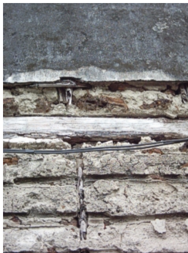
Figura 3: Degradación y pérdida del encañado Casa en Bobures, Edo Zulia Fuente: Elaboración propia (2005)
