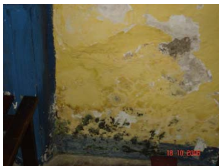
Figura 6: Humedad y moho en friso Capilla San Antonio, Edo Zulia Fuente: Arquiluz (2006)
