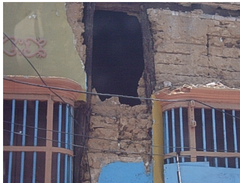
Figura 4: Relleno faltante Casa en Maracaibo, Edo Zulia Fuente: Elaboración propia (2007)
