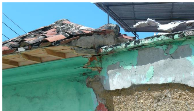
Figura 10. Desprendimiento de friso en Fachada Fuente: IERU-USB
